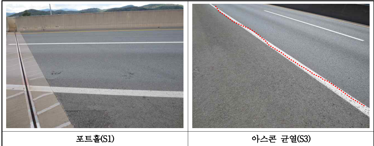
【사진 3.2.18】 교면포장 손상현황(대구)
