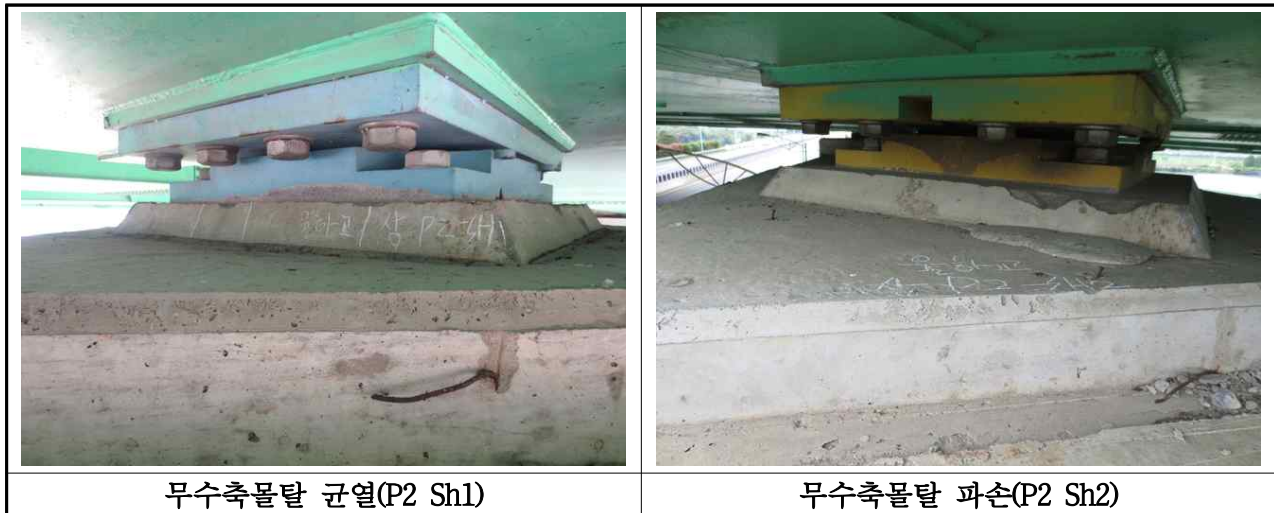
【사진 3.2.12】 교량받침 손상현황(대구)
