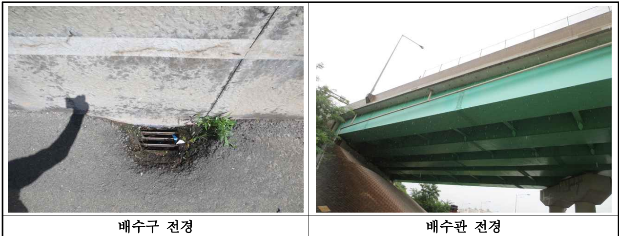
【사진 3.2.19】 배수구 및 배수관 전경(대구)
