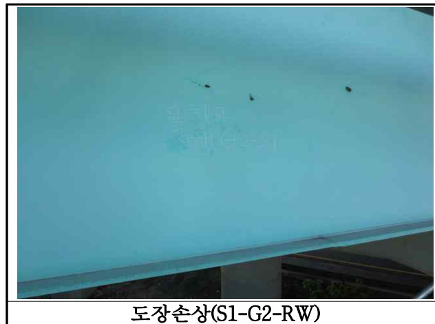
【사진 3.2.4】강박스 거더 외부 손상현황(대구)
