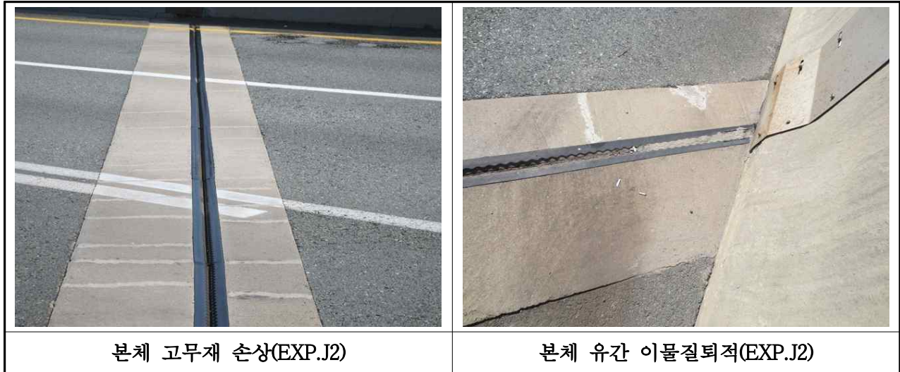
【사진 3.3.14】 신축이음장치 손상현황(부산)
