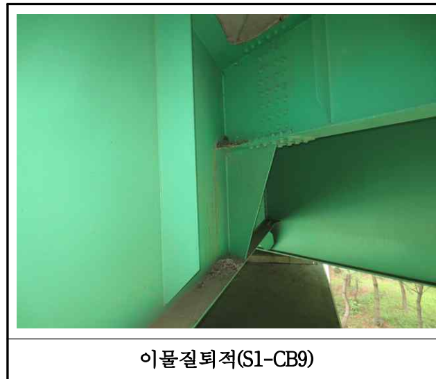
【사진 3.2.6】 가로보 및 세로보 손상현황(대구)
